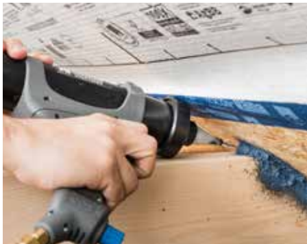
... moeilijk toegankelijke aansluitingen van balkkoppen,
