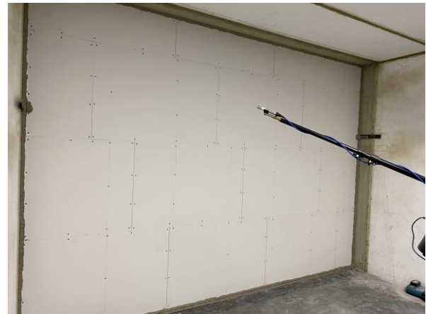
PhoneStar ST Tri Finish, ohne Putz (Ansicht vom Senderaum)
