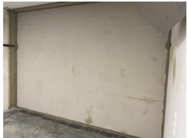
PhoneStar ST Tri Finish, verputzt (Ansicht vom Senderaum)
