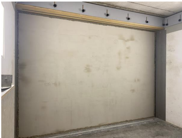
PhoneStar ST Tri Finish, verputzt (Ansicht vom Empfangsraum)
